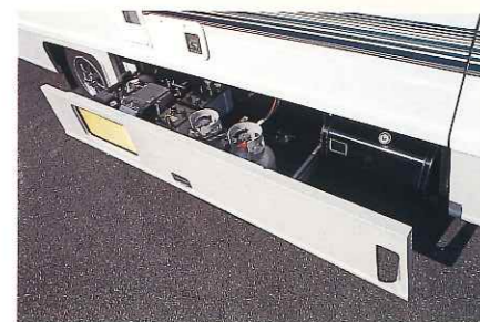
ジェネレーター/サブバッテリー/LPボンベ
