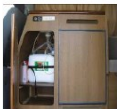
給水タンク&収納ス ベース
