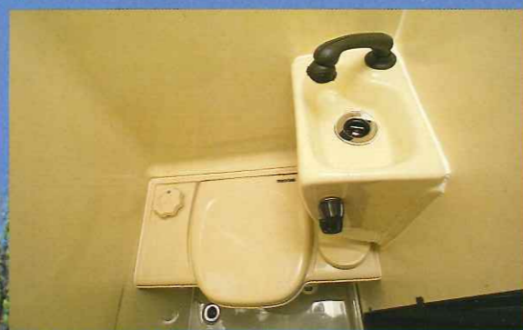
明るく使いやすいトイレ&シャワールーム
