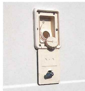
2 給水口 給水タンクへの注水口です。
